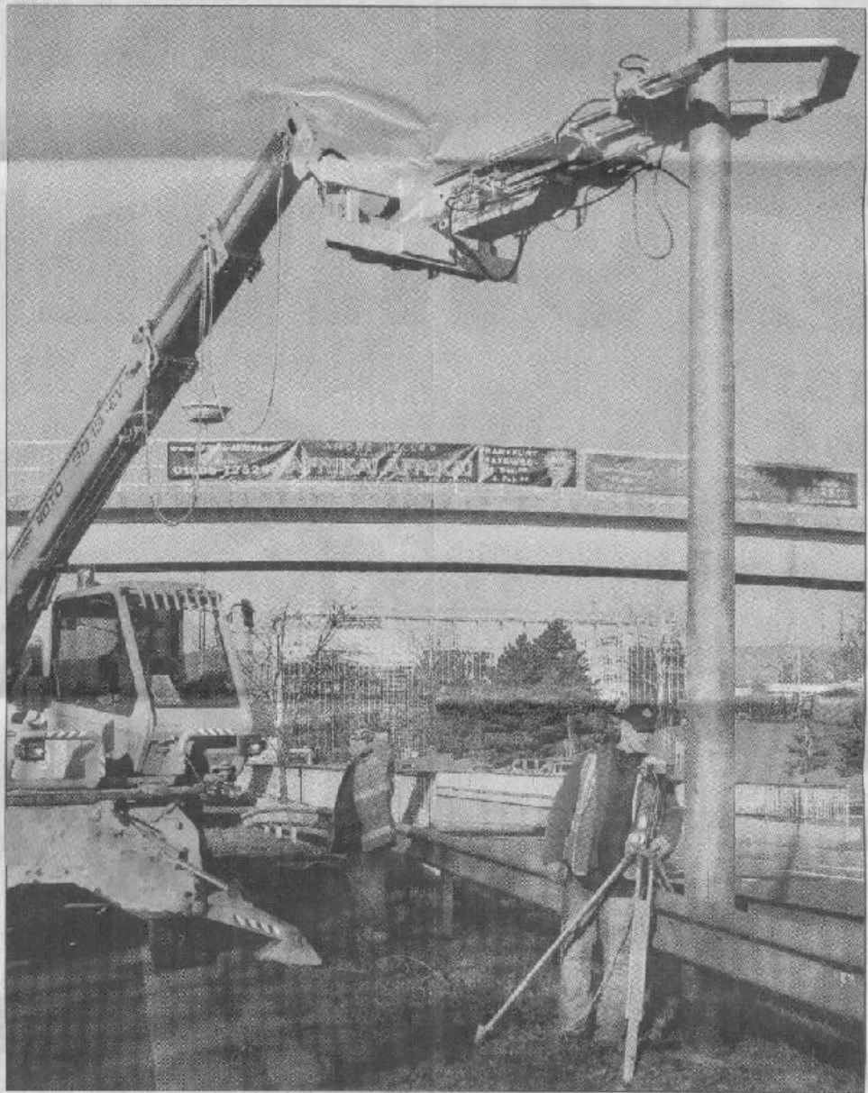
2 500 Masten – wie hier in der Berliner Straße – werden jährlich kontrolliert. Foto: ESWE Versorgung
